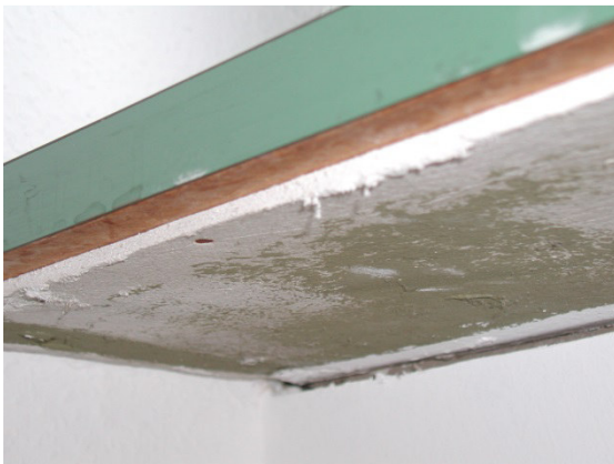
Asbestpappe unter einer Holzfensterbank
